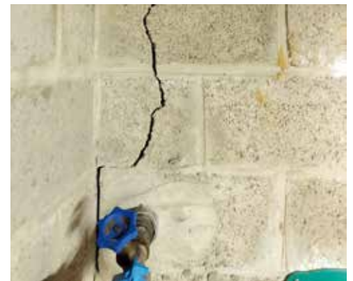
▲ De scheuren in de muren zijn angstaanjagend.
